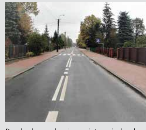
Przebudowa drogi powiatowej do drogi wojewódzkiej 634 w msc. Ostrówek, gmina Klembów. Koszt 2 037 232 zł.
